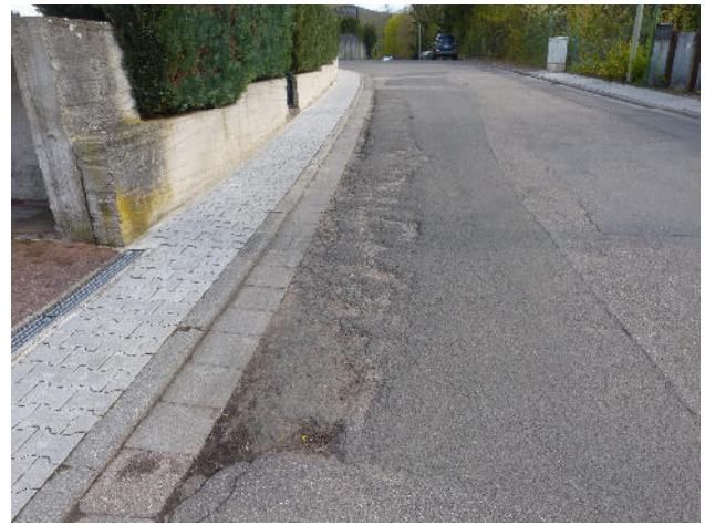
Abb. 27: Fehlmateriale wie im Drosselweg
