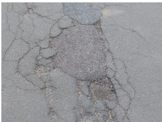
Abb. 24: Fehlstelle in der Schwarzdecke
